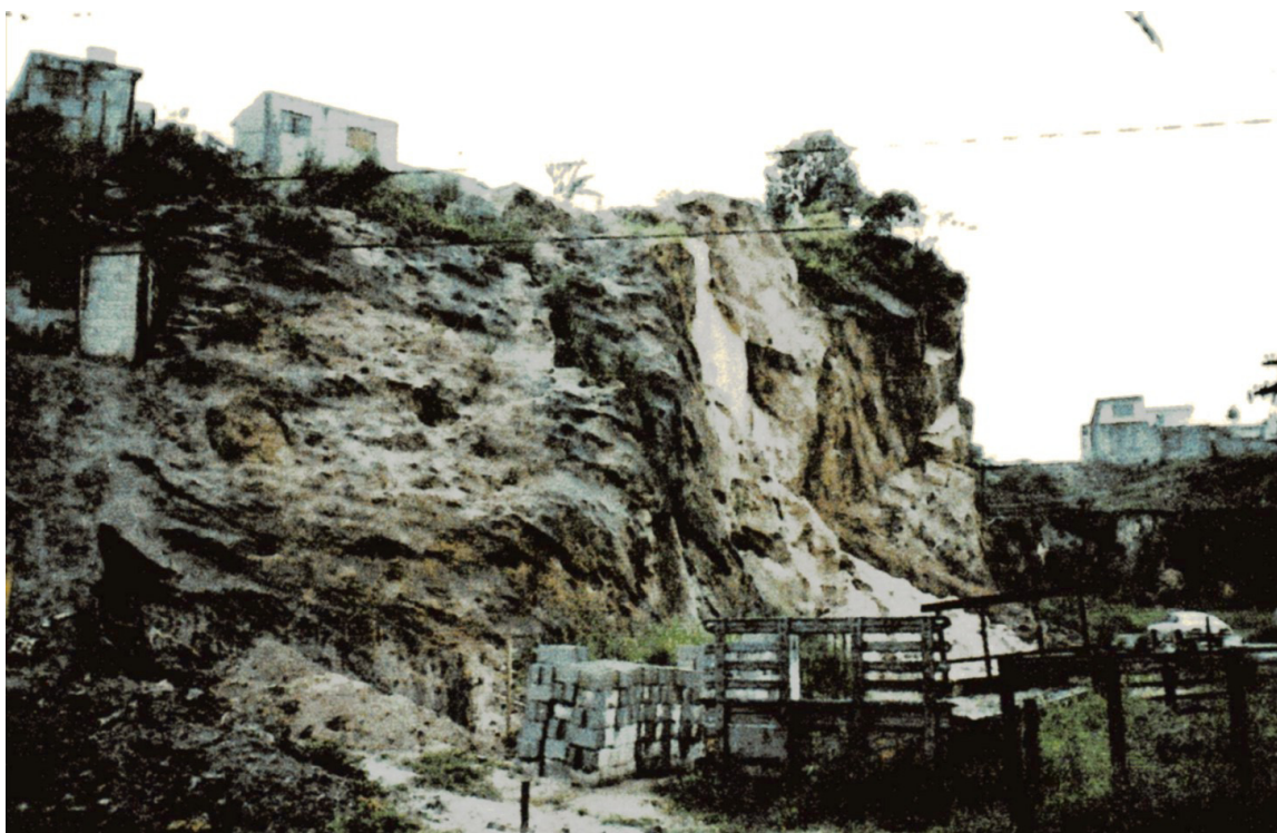
Figura 6. Relação das estruturas reliquias com a geometria dos taludes. No setor à esquerda a foliação principal mergulha para o interior do maciço, favorecendo a estabilidade. No setor à direita observa-se a intersecção de descontinuidades estruturais condicionando a queda de blocos. Micaxistos, Bairro de Itaquera, zona leste da Cidade de São Paulo.
