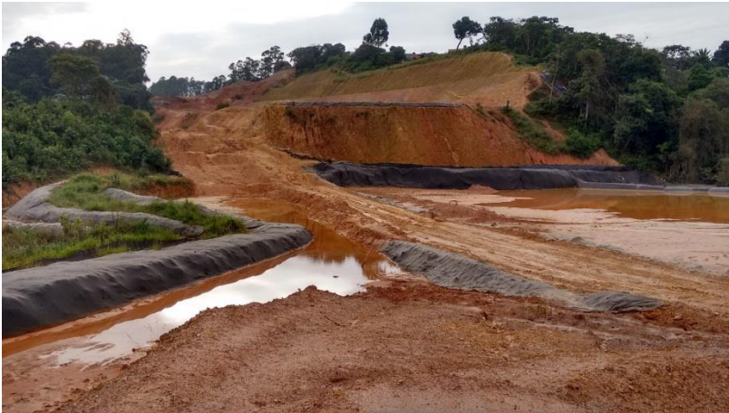
Figura 11 - Alterações do sistema de drenagem natural afetando o regime hídrico (23°23'25.97"S / 46°25'27.94"O)
