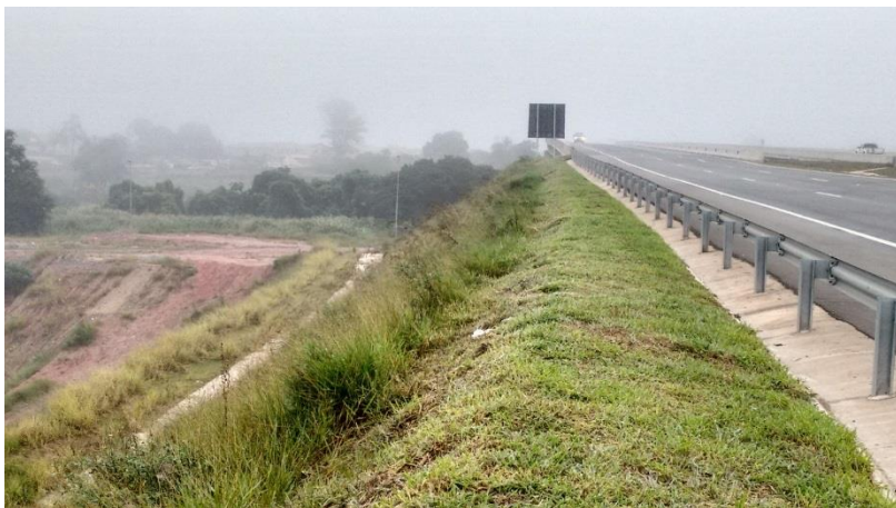
Figura 19 - Ocorrência de alteração de paisagem, com retirada de vegetação, constatação no Trecho Leste do Rodoanel ( 23^{\circ}28'46.27''S / 46^{\circ}19'47.46''O )
