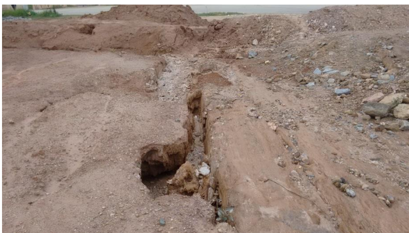
Figura 4 - Processo erosivo laminar em fase inicial em área de declividade moderada (23°24'00.83”S / 46°28'06.01”O)
