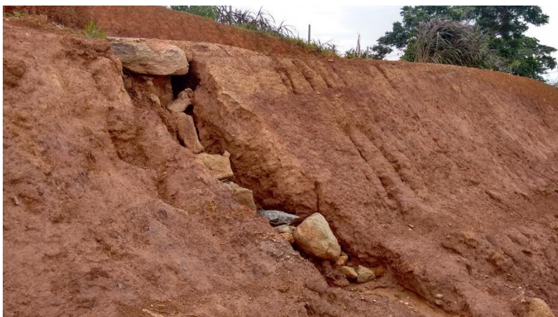
Figura 5 - Processo de escorregamento em cunha em talude (23°24'02.28”S / 46°28'04.92”O)
